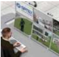
Centre de télésurveillance
